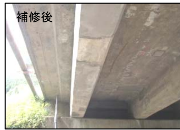
RCT桁のうき
