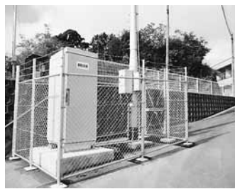
竹木場地区の防災無線設置状況
