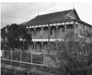
劣化した唐津歴史民俗資料館
