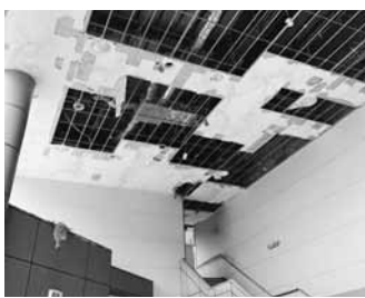
ひれふりホールの被害状況
