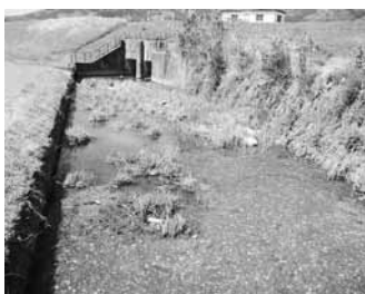
水路に堆積した土砂
