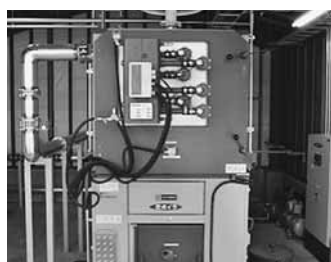
なな湯のチップボイラー
