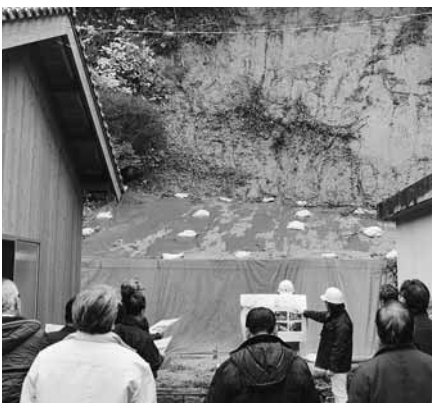
災害関連地域防災がけ崩れ対策事業費(浜玉町)
