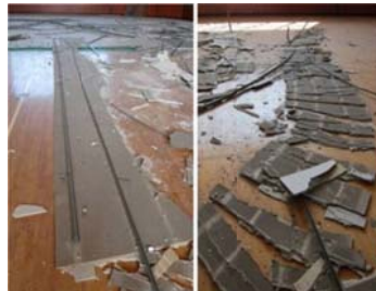
図：脱落した天井部材
