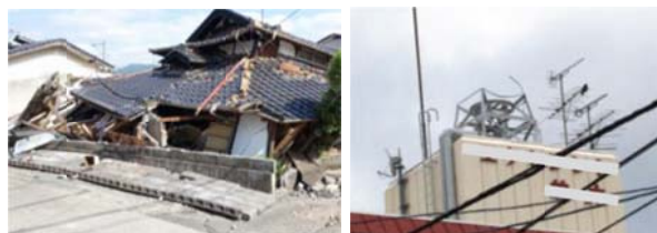
図：ブロック塀・屋上突出物の被害 (写真：国土交通省国土技術政策総合研究所)
