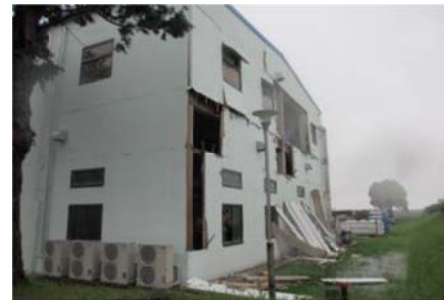
図：外壁の落下
