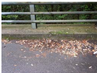
写真6 排水柵の土砂詰まり
