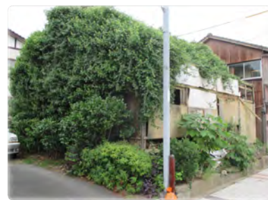
危険な空き家
