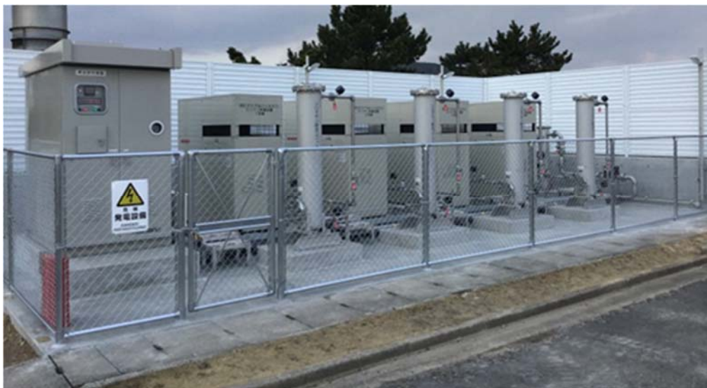
図-5.1 下水バイオガス発電設備
