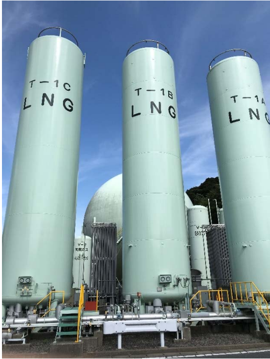
図一4. 34 LNG 貯蔵タンク
