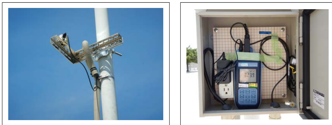
図-2. 11 仮設日射量計の設置
