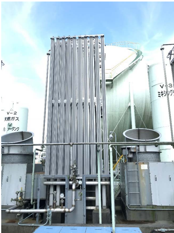
図一4. 35 LNG 気化器
