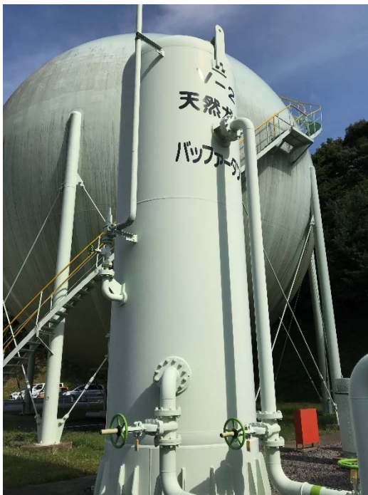
図一4. 39 天然ガスバッファタンク
