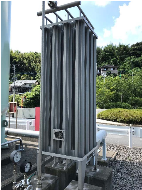
図一4. 37 LNG 加圧蒸発器
