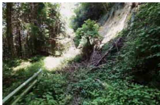
林道椿山線 被災の様子
