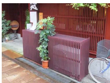
建物の外観と調和を図った室外機の収納ケース
