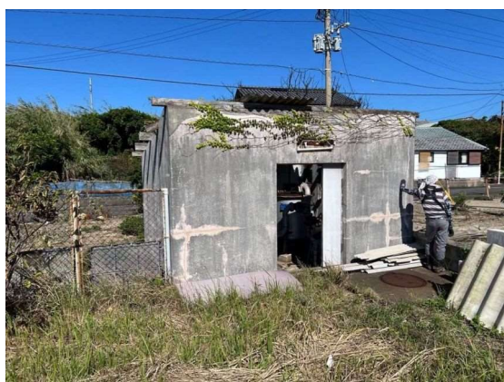
プール機械室
