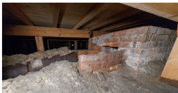
本館 床下配管
