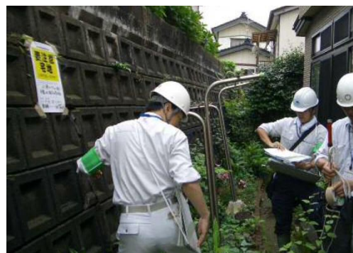
図：被災宅地危険度判定の状況
