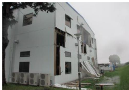
図：外壁の落下 (国土交通省国土技術政策総合研究所資料)
