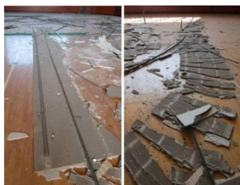
図：脱落した天井部材
