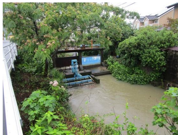
排水路のフラップゲート（逆流防止）
