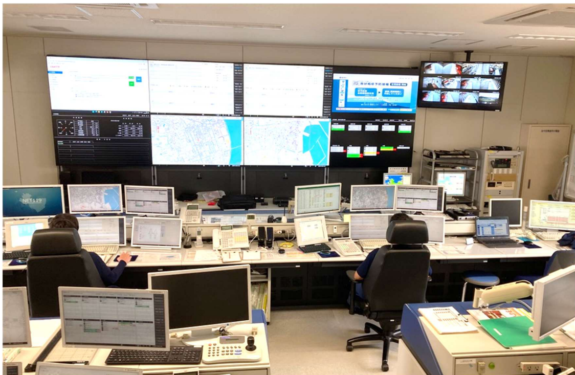
消防指令センター
