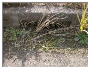
写真 3-1 排水柵の土砂詰まり
