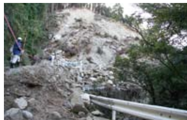
▲7月の豪雨により市内各所で被害が発生
