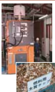
▲木質チップボイラーと木質チップ
