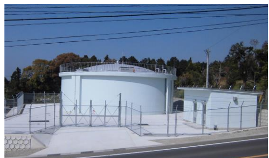
新木場配水池(肥前町)
